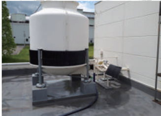
▶ บำบัดน้ำในหอระบายน้ำเย็น (Cooling Tower)
