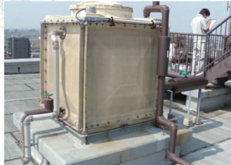
▶ บำบัดน้ำในถังเก็บน้ำยกสูง (Elevated Tank)
